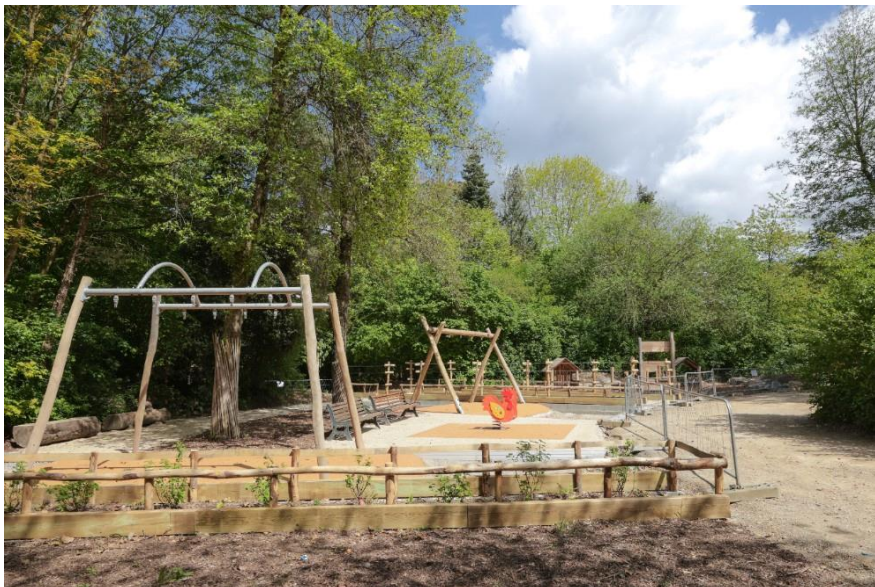
Chantier de l'aire de jeux inclusive du parc du Landry (c) Julien Mignot - Rennes Ville & Métropole
