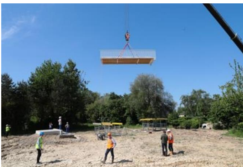
Pose du 1 er tronçon de la passerelle Motte-Brûlon - ©Ville de Rennes / D.Gouray
